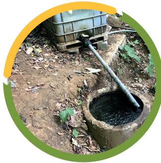
Figura 2. Tanque y tubería de alimentación. Fuente: INTA, 2018.
